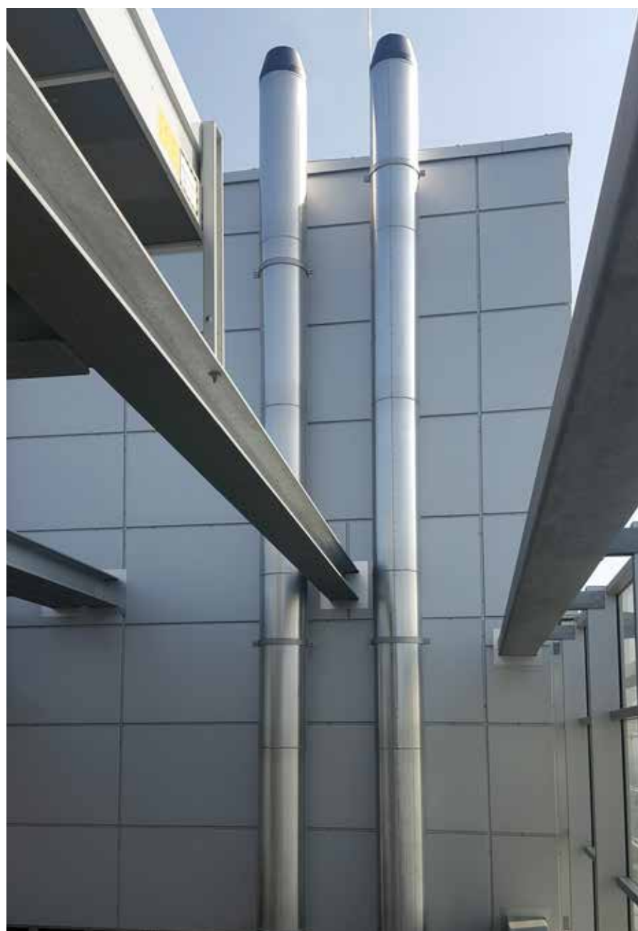
“Op het dak hebben we twee aluminium gelaste schoorstenen van eigen fabricaat geplaatst, die voor de afvoer van de rookgassen van de ketels zorgen.”
