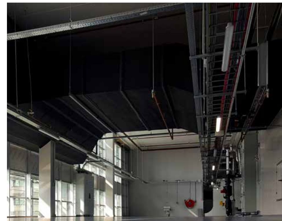
Alle plenums en een groot deel van het kanaalwerk zijn geïnstalleerd op de 14e verdieping, die volledig als technische ruimte is uitgevoerd.
